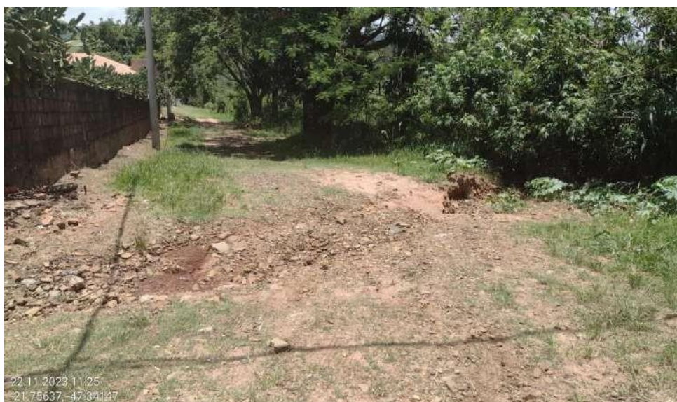
Figura 33: Erosão em rua no Distrito de Santa Cruz da Estrela. Fonte: ENGTEC
