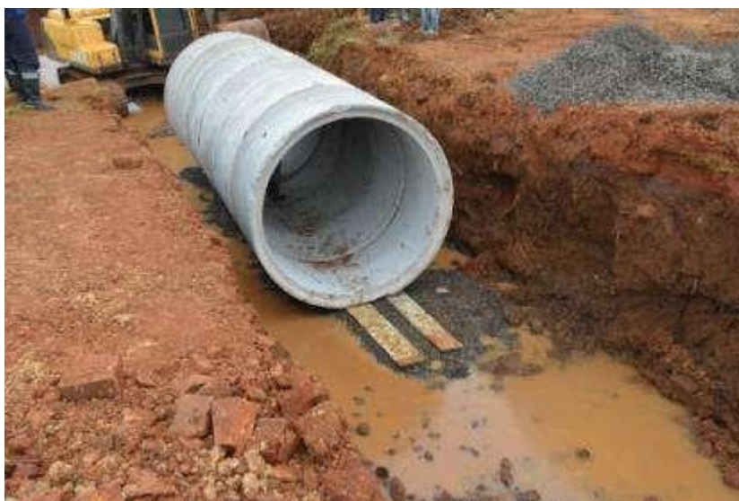
Figura 91: Galeria de 1000 mm. Fonte: ENGTEC (2023).
