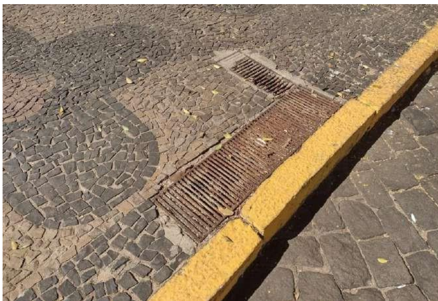
Figura 02: Bueiro na região central. Fonte: ENGTEC (2023).
