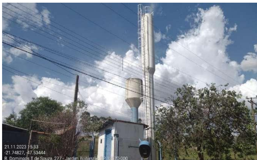
Figura 15: Captação Subterrânea e Reservatório no Distrito Albinópolis. Fonte: ENGTEC (2023).
