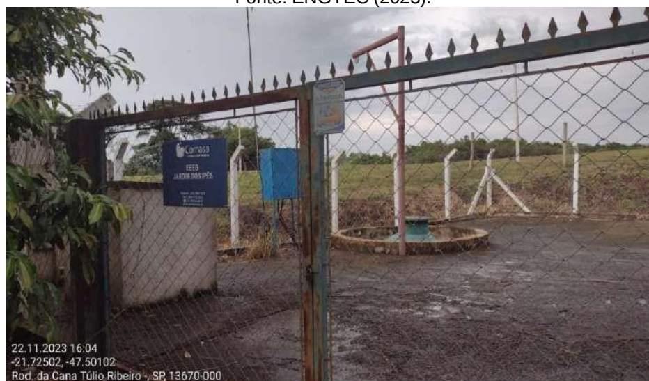
Figuras 30: Estação Elevatória do Jardim dos Ipês.
